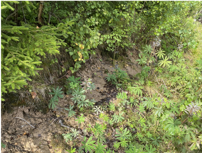
Figur 2: Mindre ras i siltjord i vägslånt vid korsningen Hasselstigen och Västkustvägen (2023-08-15).
