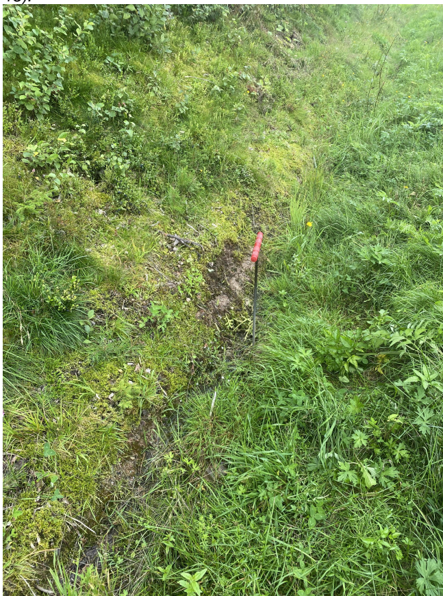
Figur 3: Mindre utläckage av grundvatten i vägdikey längsmed Västkustvägen (2023-08-15).
