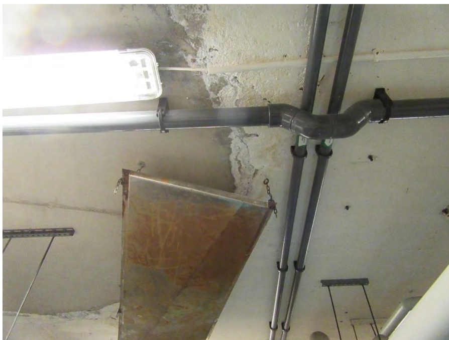
BILD 26. Spår av tidigare läckage i område under bubbelpool.
