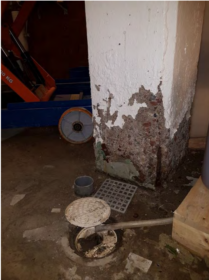
Foto 17. Korrosionsskador i pelare
