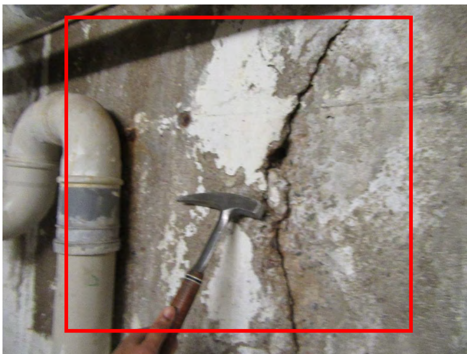
BILD 11. Bområde med spricka i väggen.
