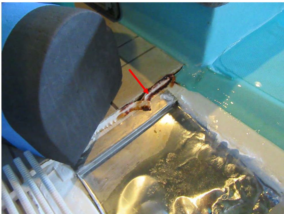
BILD 32. Släppt mjukfog vid hörnan av lilla bassängen. Missfärgning av rost.
