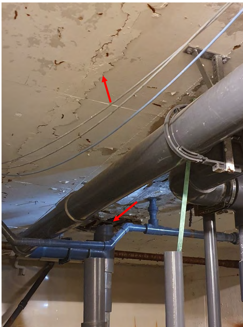
BILD 20. Reningsbassängen. Spjälkning i taket/Undersida lilla bassängen.
