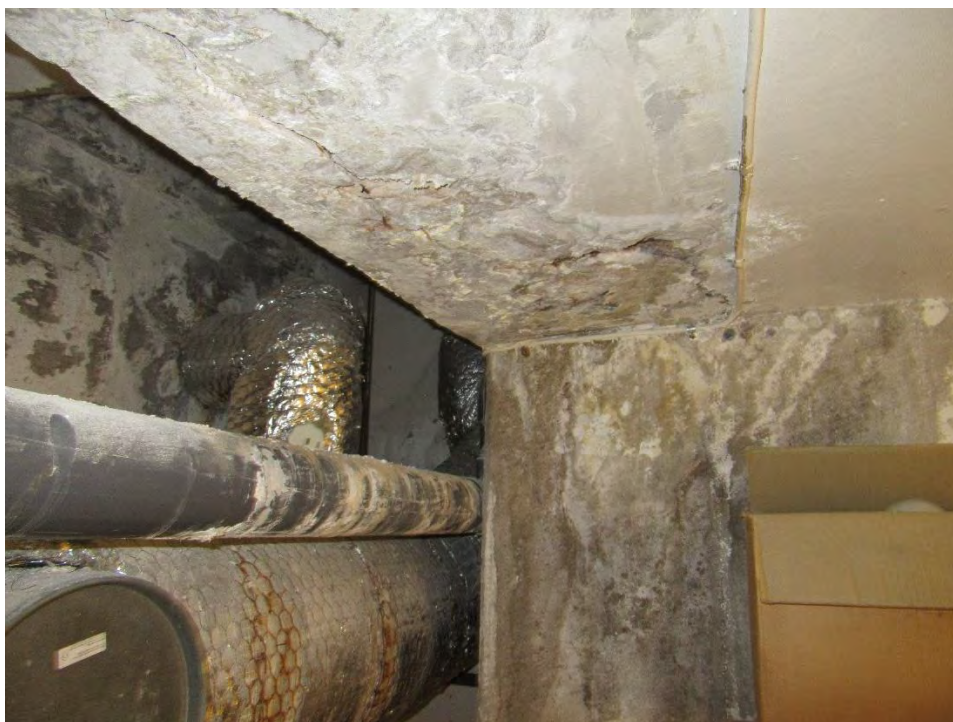
BILD 22. Spår av tidigare läckage samt skador i svalprännen och pelare.
