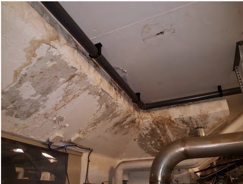
Foto 12. Läckage i anslutning till bjälklag, Övningsbassängen
