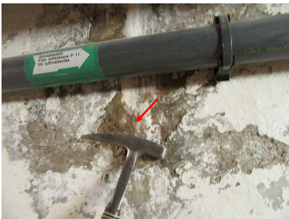
BILD 9. Aktivt läckage på väggen.
