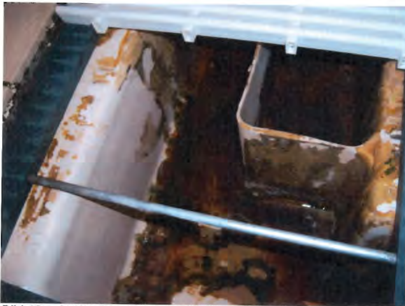
Bild 10 – Anslutning mellan golvklinker och överloppsränna.
