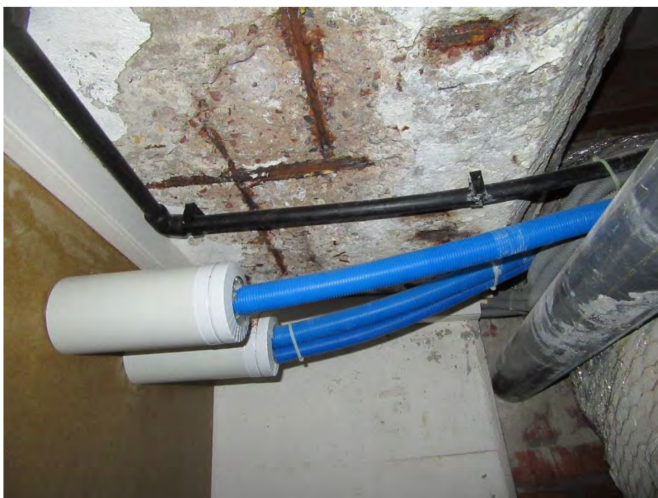
BILD 21. Lilla bassängen, hörna vid skvalpräna. Spjälkning.
