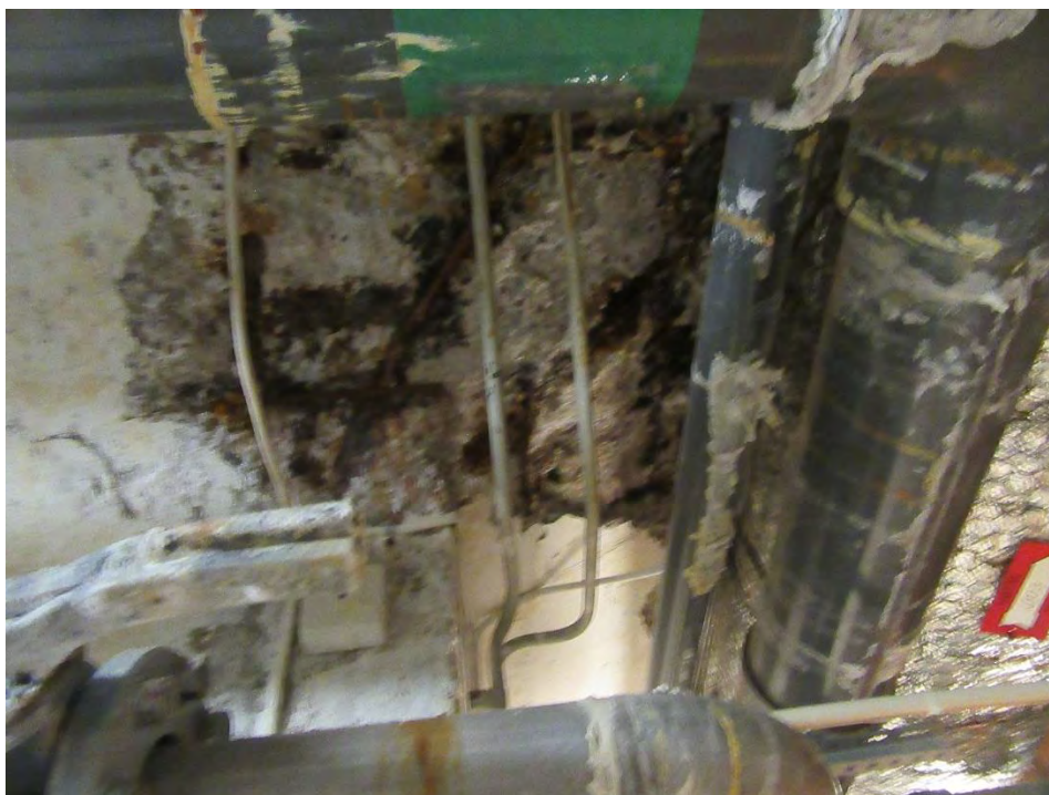
BILD 10. Hörna mellan kortsida östra väggen och långsida södra väggen. Skvalprännen väldigt skadad av spjälkning orsakat av armeringskorrosion.
