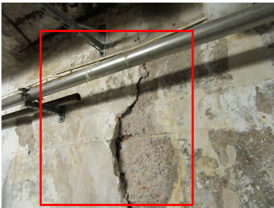
BILD 13. Bområde och större lossnad bit. Bompartier och aktivt läckage i direkt närhet.
