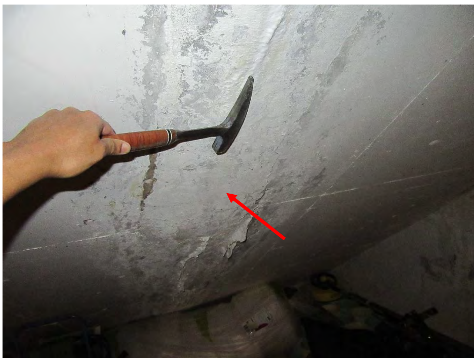
BILD 17. Avflagningar av färg, bområde. Eventuellt en gammal lagning. Under stora bassängen.
