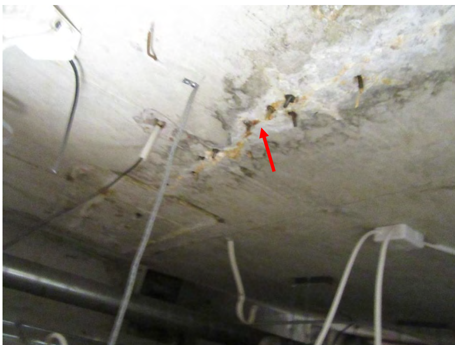
BILD 27. Under plaskbassängen där det enligt beställare droppar när simhallen nyttjas av besökare. Bilden visar nipplar och injekterad spricka.
