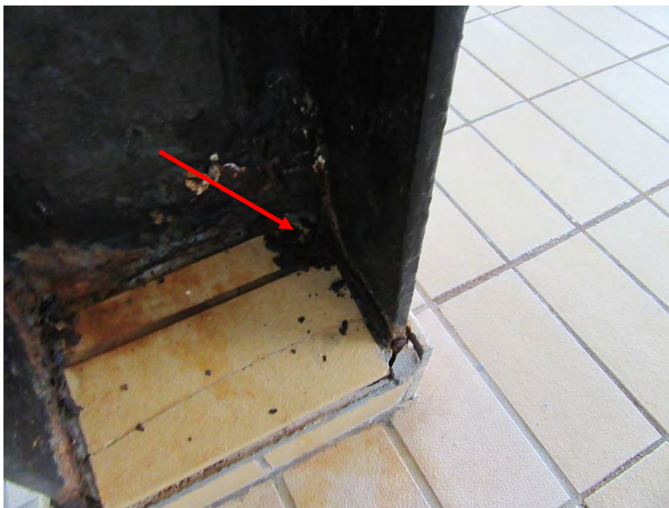
BILD 30. En till pelare med rostangrepp samt kakelsläpp.
