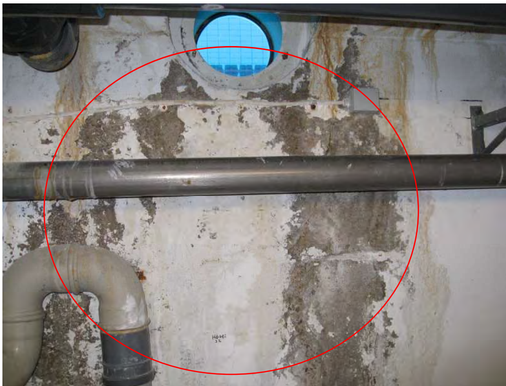
BILD 6: Avflagningar och lös betong på stora bassängens vägg invid den sista ventilen på den djupa delen av den västra sidan. Betongen kommer att falla av och utgör inget skydd utan bör tas bort.
