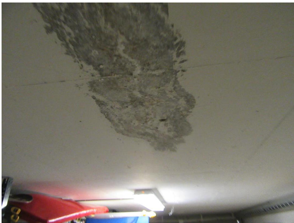
BILD 16. Avflagningar i förrådstaket/Undersida stora bassängen.
