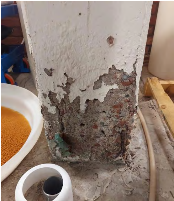
Figur 2.5.1 – Spjälkningsskada vid pelarfot, armering blottlagd och utsatt för korrosion.
