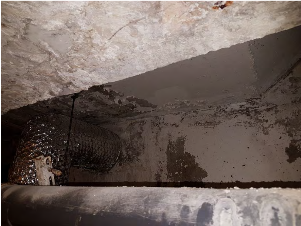
Foto 15. Spricka p g a armeringskorrosion i vot. Övningsbassängen
