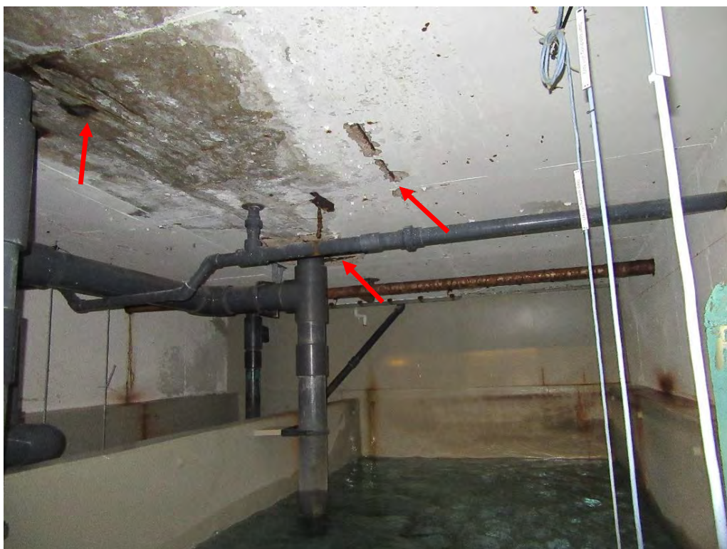
BILD 19. Reningsbassängen samt lilla bassängens undersida med korrosionsskador.
