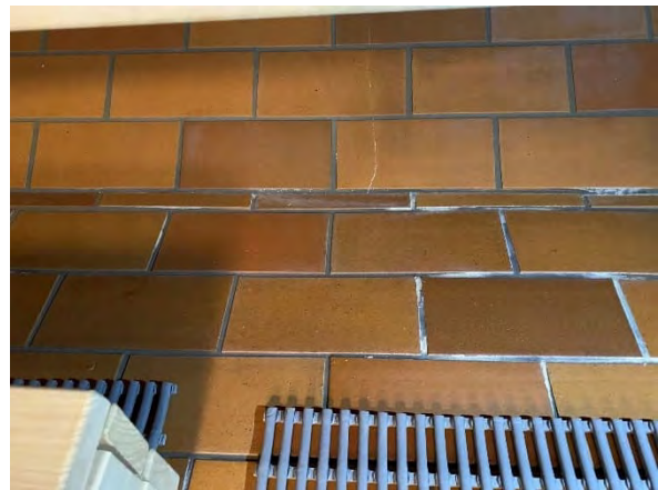
Figur 2.6.2 – Sprickbildningen vid mötet mellan planet och golvet.
