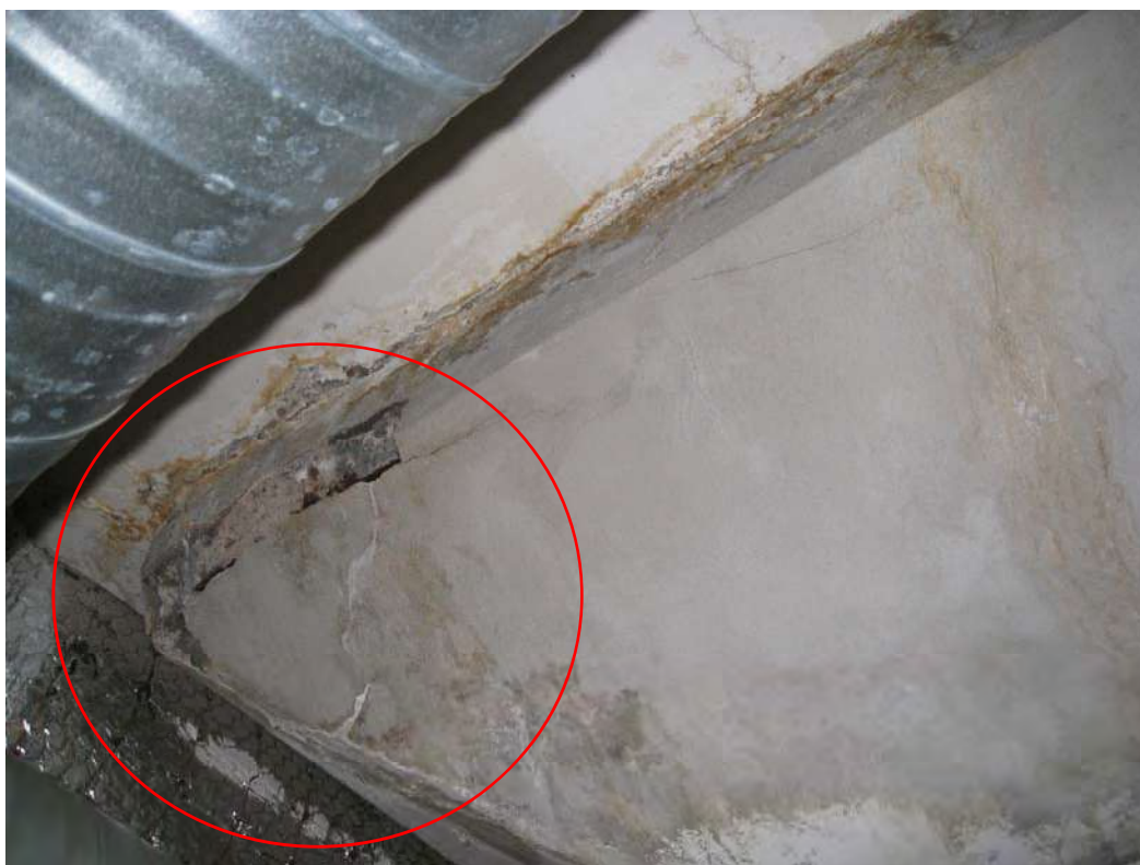
BILD 7: En dålig utförd lagning av tidigare spricka, stora bassängens nordvästra hörn. Armeringen fortsätter att rosta i lagningen och betongen lossnar i stora bitar.
