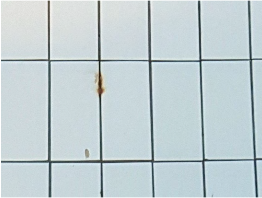
Foto 11. Brun missfärgning i bassäng, Stora bassängen
