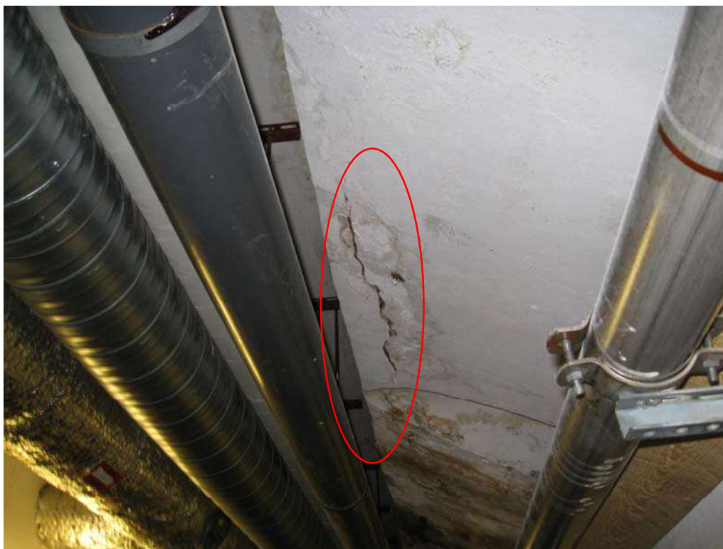
BILD 5: Typisk spricka vid skvalprännans hörn i underkant. Det är hörnarmeringen som rostar och spjälkar betongen. På bilden visas spricka på bassängens västra sida.
