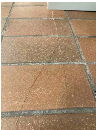
Figur 2.4.2 – Sprickbildning i klinkerplattorna intill den åtgärdade skadan.
