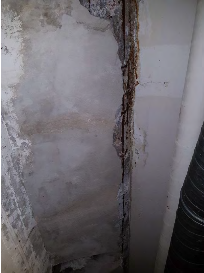
Foto 7. Tidigare lagning av vägg- vot, Stora bassängen
