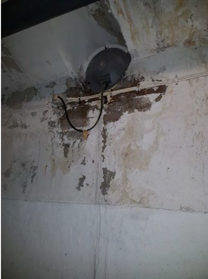
Foto 5. Läckage vid armatur Stora bassängen
