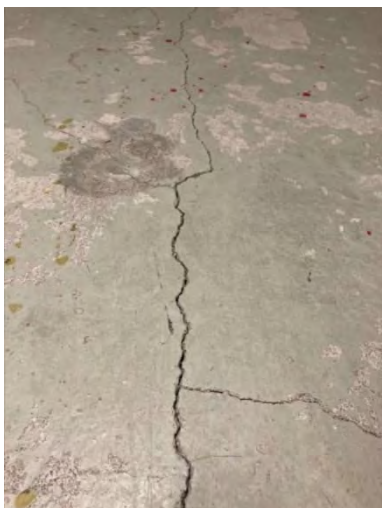
Figur 2.2.1 – Sprickbildning i betonggolvet.
