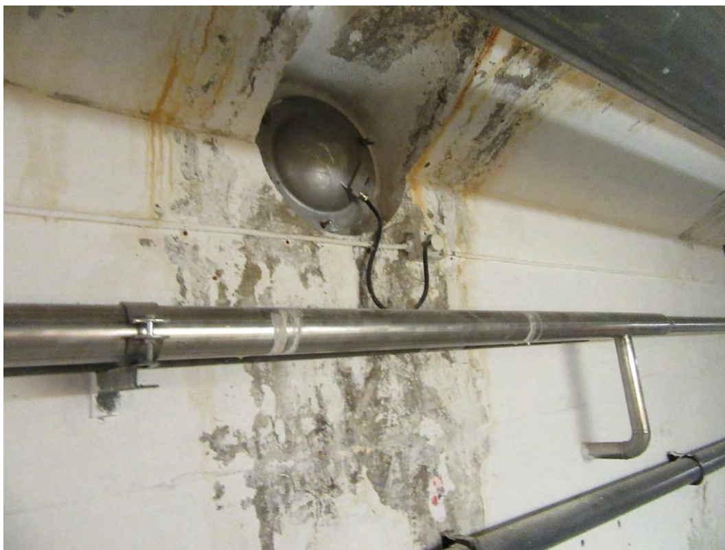
BILD 6. Spår av tidigare läckage kring armaturen.
