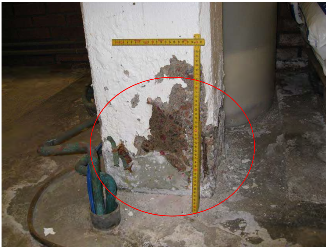
BILD 9: Provad pelare (ensam pelare mot bowlinghallen) i maskinrummet är anfränt och behöver renoveras.
