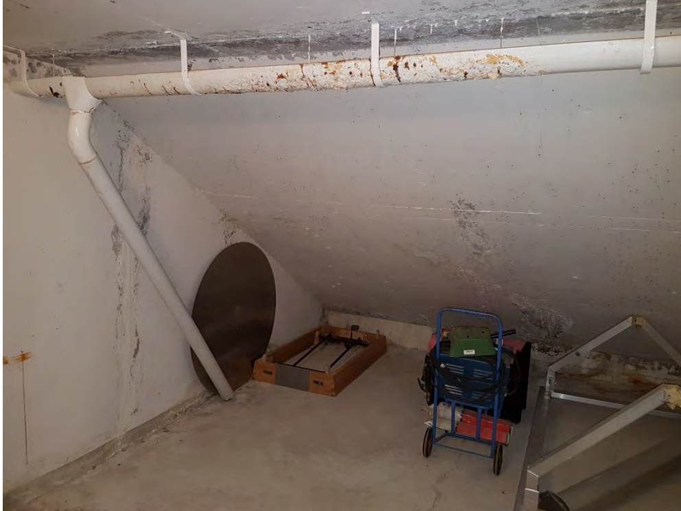
Foto 9. Läckage vi sprickor och gjutfog i bottenplatta, Grunda delen, Stora bassängen
