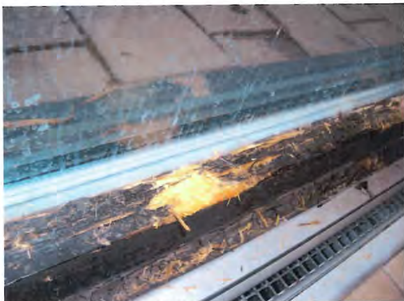
Bild 1 – Rötskador i fönsterkarmar utmed 25-meters bassängen
