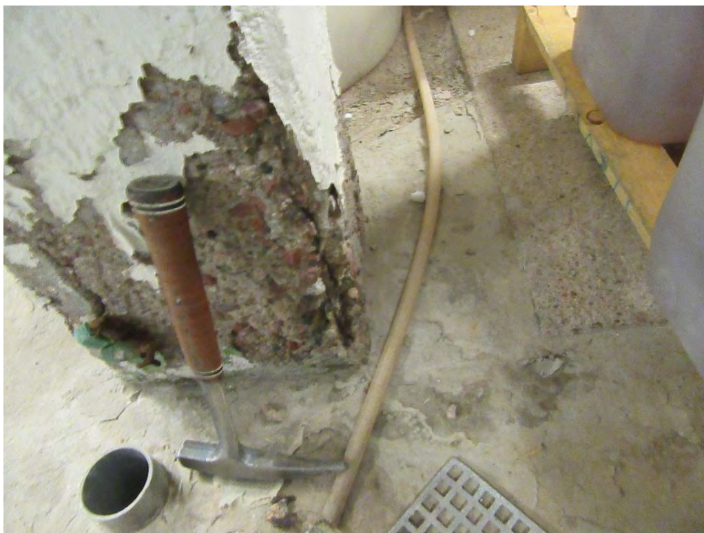
BILD 24. Pelare i undercentralen under simhallsdelen. Spjälkning.
