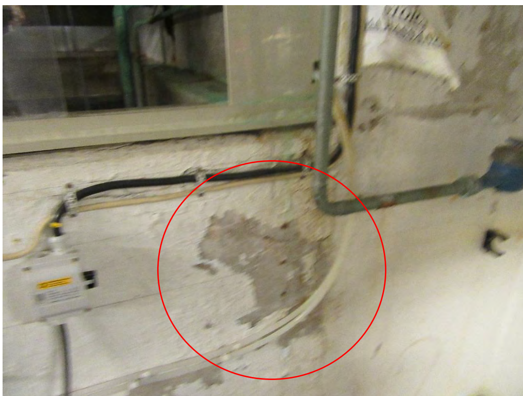
BILD 25. Färgavflagningar på reningsbassängens yttervägg.
