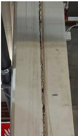
Figur 2.1.1 - Vertikal spricka i dilatationsfog.
