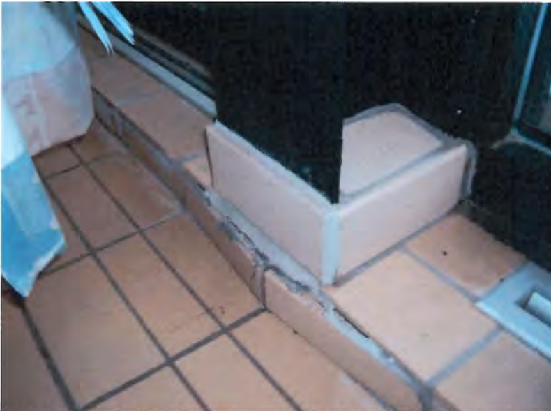
Bild 8 – Golvklinker vid anslutning mot bröstning för ventilationskanaler/stålpelare.
