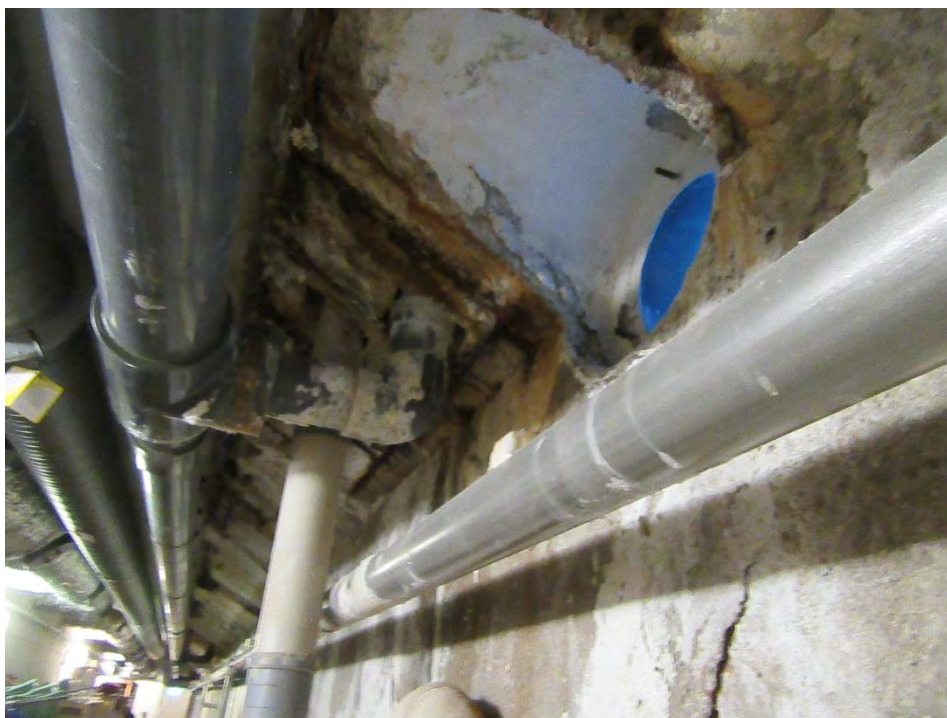
BILD 12. Kraftiga spjälkningskador under skvalprännen orsakat av armeringskorrosion.
