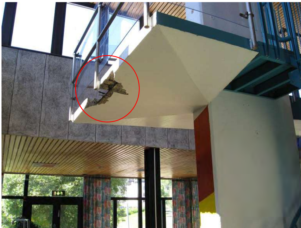
BILD 10: Betongen i hoppturnet är spjälkad pga armeringskorrosion orsakad av karbonatiserad och fuktig betong.
