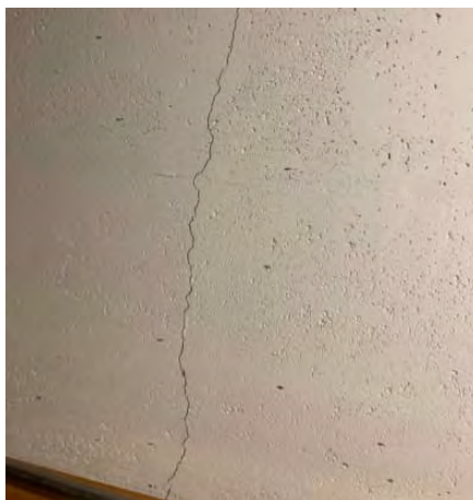
Figur 1.2.2 – Sprickbildning i bärande betongvägg.
