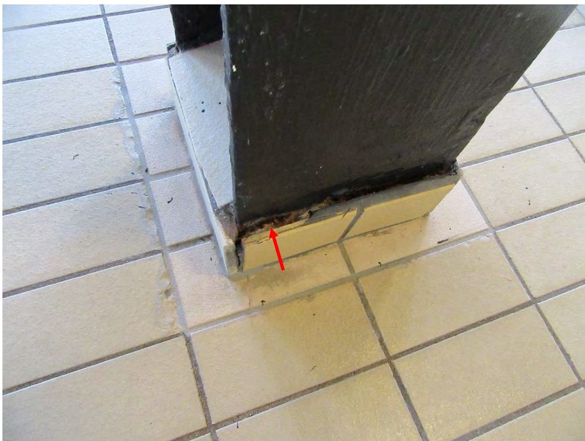
BILD 29. Pelare med rostangrepp samt kakelsläpp.
