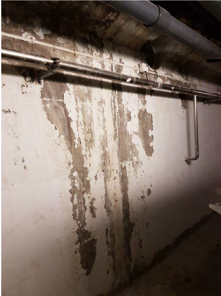
Foto 3. Läckage i anslutning till gjutfog, Stora bassängen
