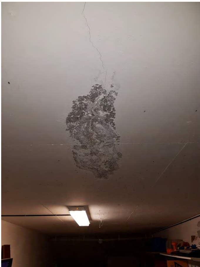
Foto 8. Läckage vid spricka i botten- platta, Grunda delen, Stora bassängen
