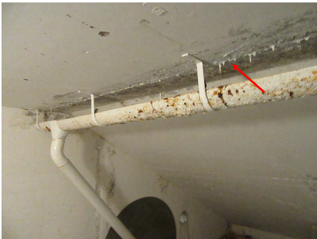
BILD 18. Spår av tidigare läckage. Undersida stora bassängen.
