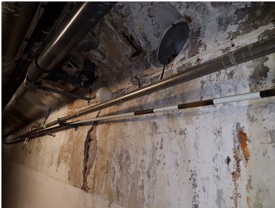
Foto 4. Spjälkad betong, Läckage från vot, Stora bassängen
