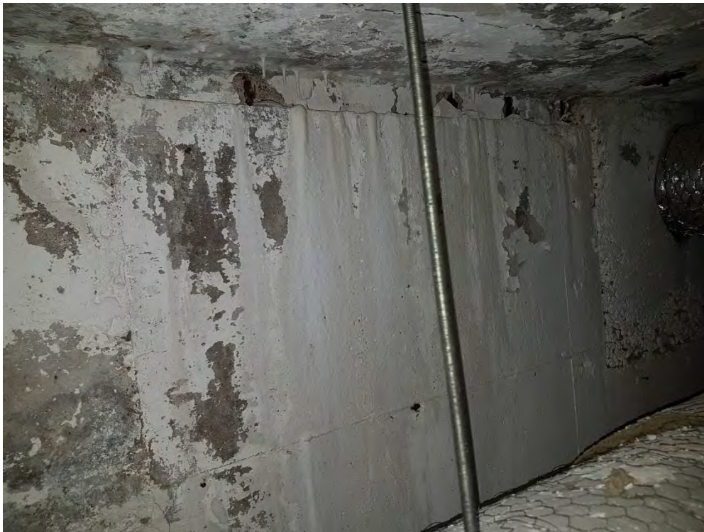
Foto 16. Läckage i fog. Övningsbassängen
