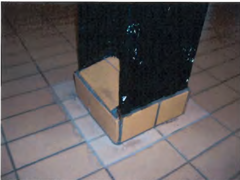
Bild 8 – Golvklinker vid anslutning mot stålpelare. Plattor runt pelarfot har bytts ut, korrosionsskador.
