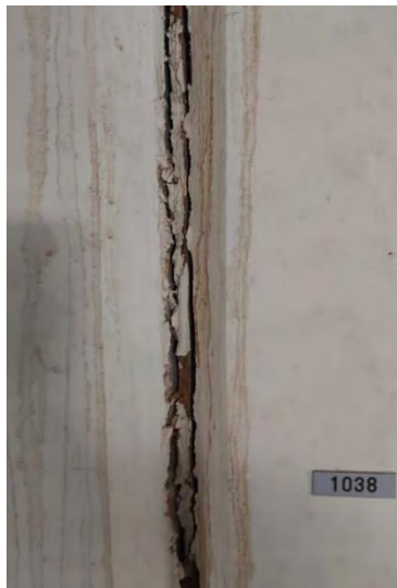
Figur 2.1.2 - Rester av fogmaterial samt mellanliggande träfiberskiva.
