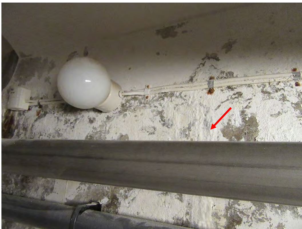
BILD 7. Område med aktivt läckage i hörnan till kortsidan österut. Blöt vägg, avflagningar och rostade ståldetaljer.
