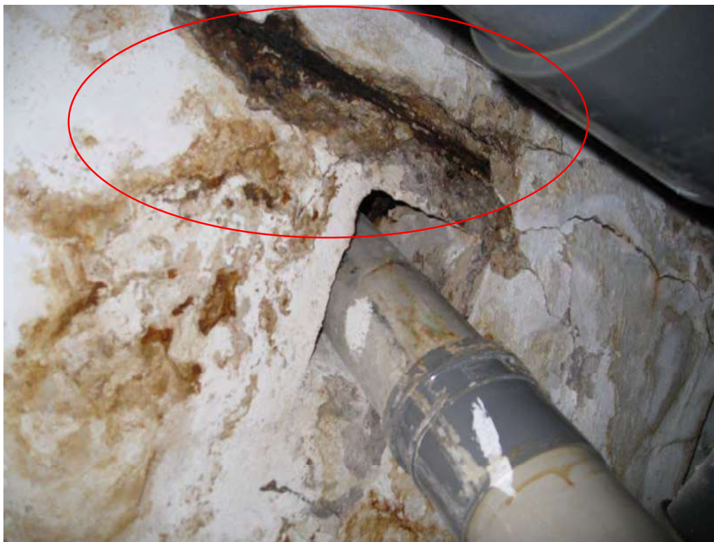
BILD 8: Bilden visar den rostiga hörnarmeringen i underkant av skvalprännen vid bassängens sydvästra hörn.
