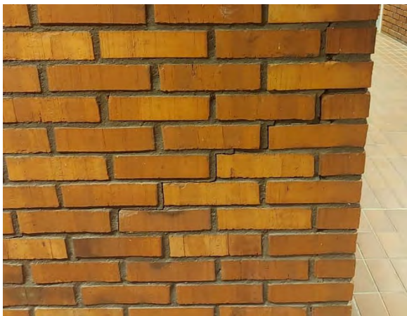
Figur 2.3.1 – Genomgående spricka i tegelväggens fog.
